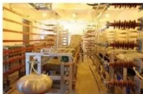
电网故障发生装置
