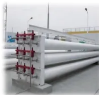
高压储氢设施
