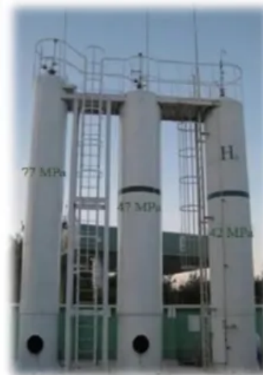
高压储氢设施
