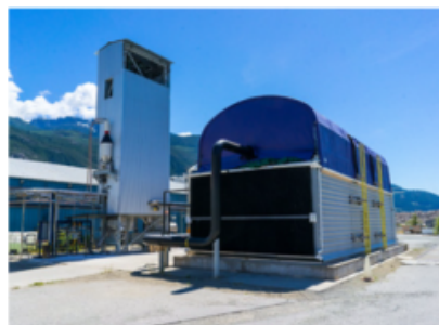
碳工程公司的直接空气捕集工厂试点。图中为空气接触器和燃烧炉（左） 图片来源: Carbon Engineering Ltd.
