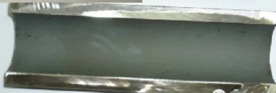
三级过热器第7-38根管破开内壁情况
